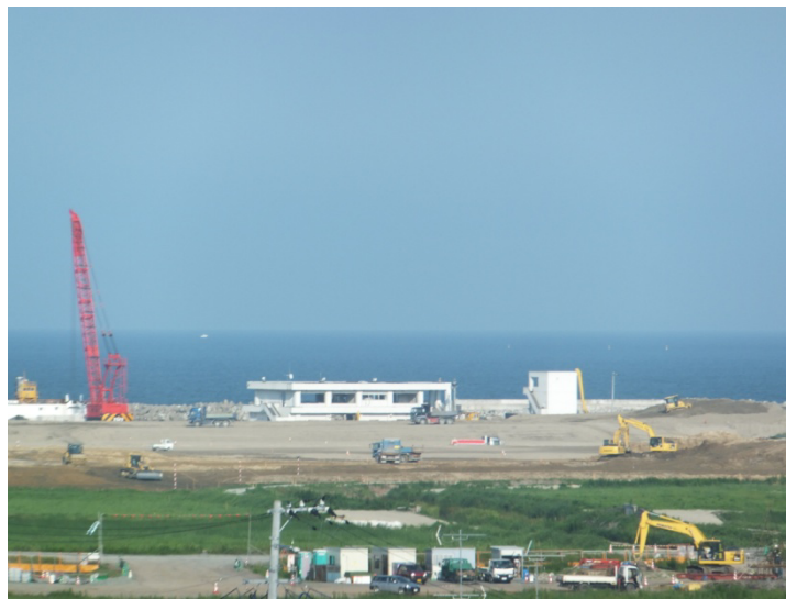
役場屋上から見た海岸の風景です 海岸の堤防や常磐線の復旧が急ピッチで進められています
